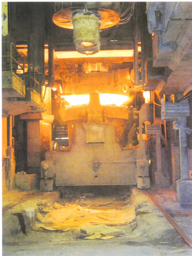
Рис. 1. Установка «печь-ковш» ЭСПЦ-2
