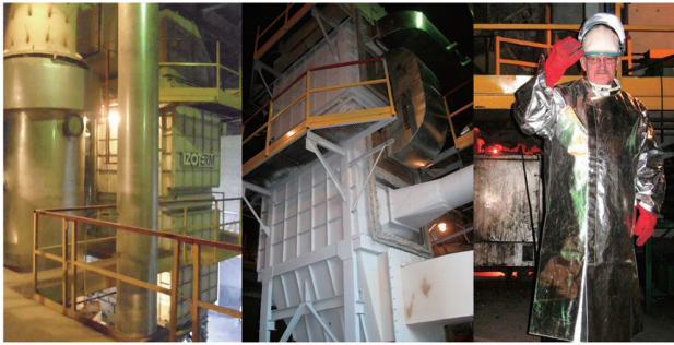
Система рекуперации и подогрева дутья для минераловатной вагранки (завод «Изотерм», Усть-Каменогорск, Казахстан, 2011г.)
